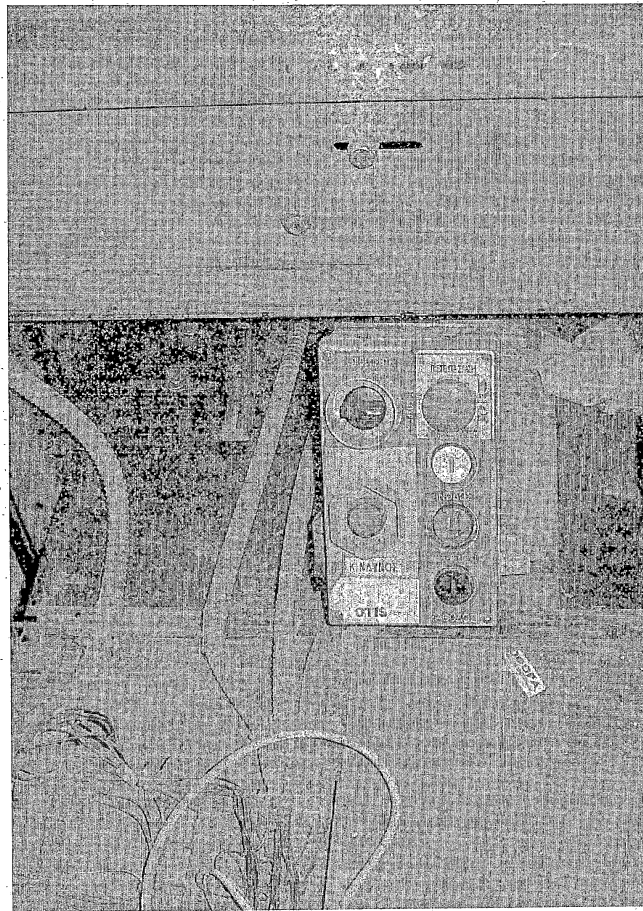
Φωτογραφία 6: Υπάρχον χειριστήριο οροφής θαλάμου
