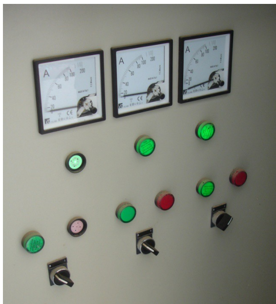
Φωτ. 5: Υπάρχων ηλεκτρικός πίνακας
